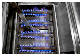
O aquecimento é feito mediante queimadores tubulares, distribuídos sob o do reservatório
